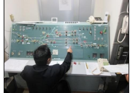
・ 補助制御盤訓練
