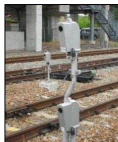
踏切障害物検知装置
