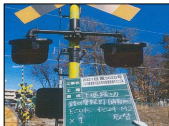
・警報灯更新後
