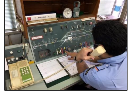
・ 補助制御盤訓練
